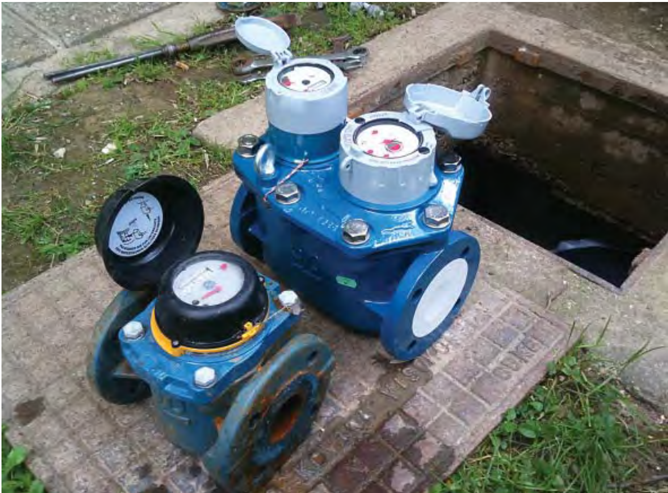
Slika 3. Korišteni vodomjeri profila DN 50 pri usporednom mjerenju: a) postojeći – stari i b) novi – kombinirani vodomjer
